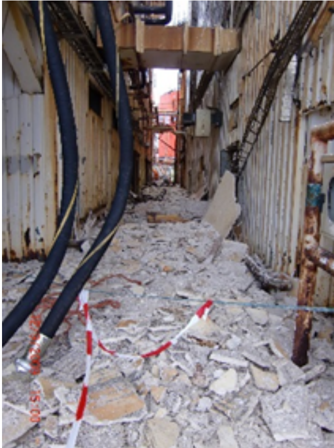
Bilde Passiv brannbeskyttelse har falt ned.
