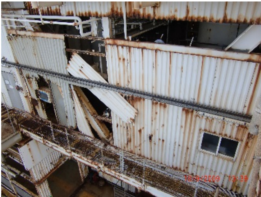
Løse veggplater og korroderte gangveier
