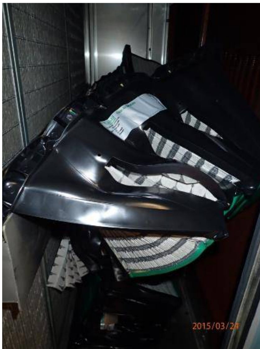
Figur 5 - Deformerte luftfilterkassetter i AHU-B, som ligger rett ved siden av AHU-A (Kilde: Ptil gransking).
