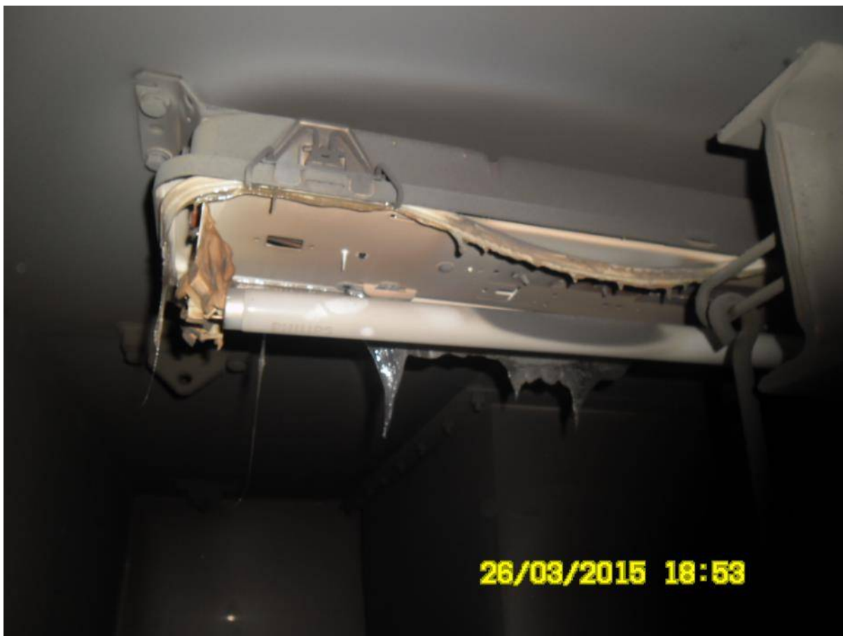
Figur 6 - Bilde av lysarmatur inne i viftehuset i AHU-A (Kilde: Ptil gransking)
