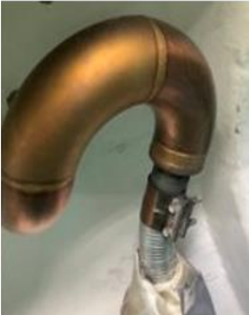
1. Eksoslekkasje mellom fleksibel og fast del av eksossystemet
