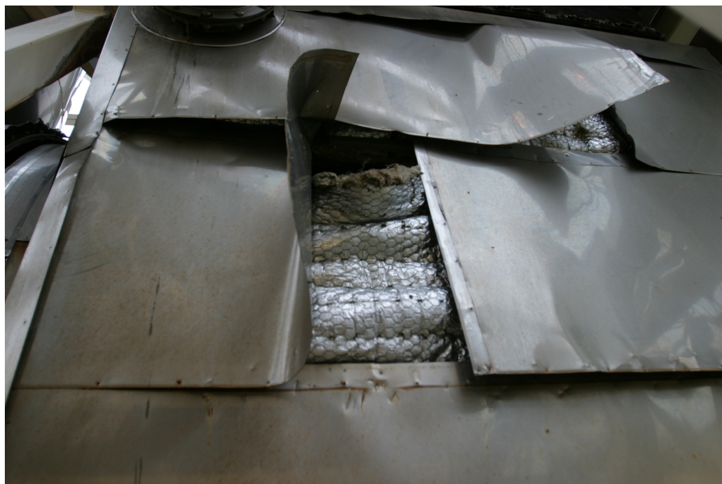
Figur 5 Åpnet isolasjon på varmeveksler
