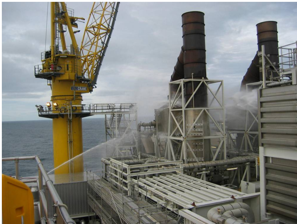
Figur 2 Slokking/kjøling av eksoskanal HGA
