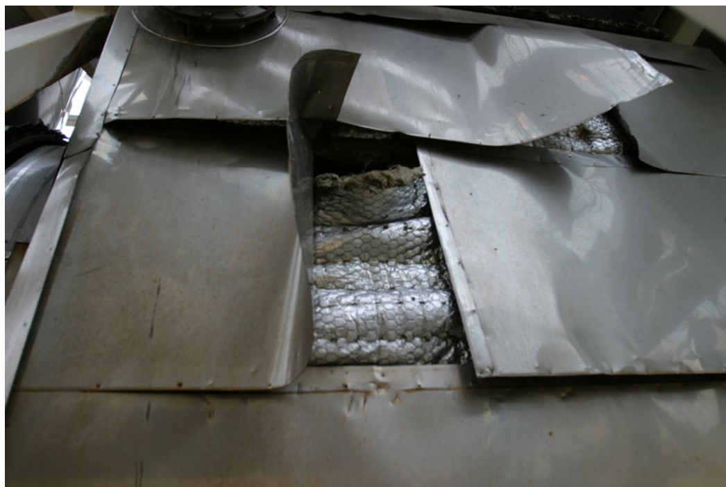
Figur 5 Åpnet isolasjon på varmeveksler
