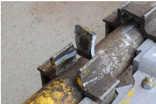
Bilde 5. Ødelagt feste for lengdebjelke
