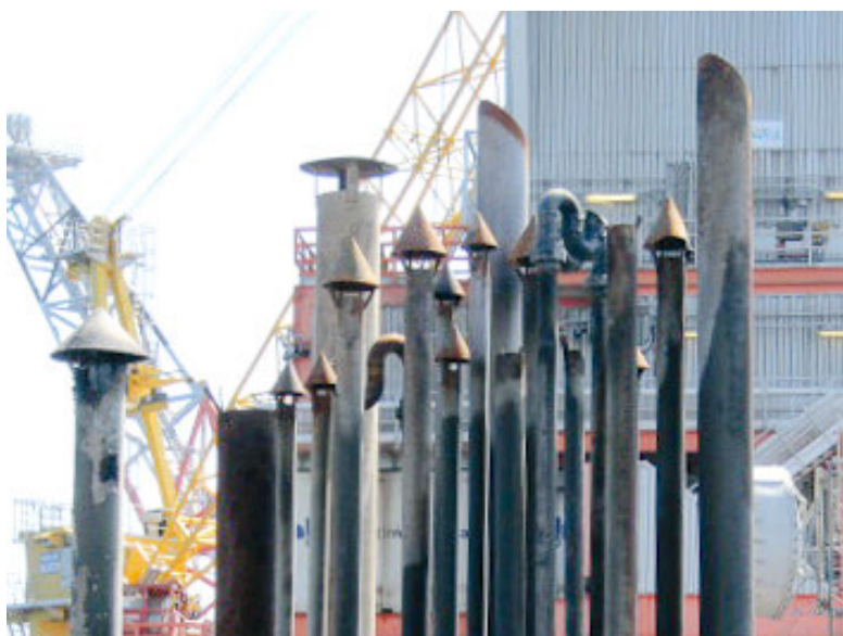
Figur 5 Avluftsingsrørene etter slokking
