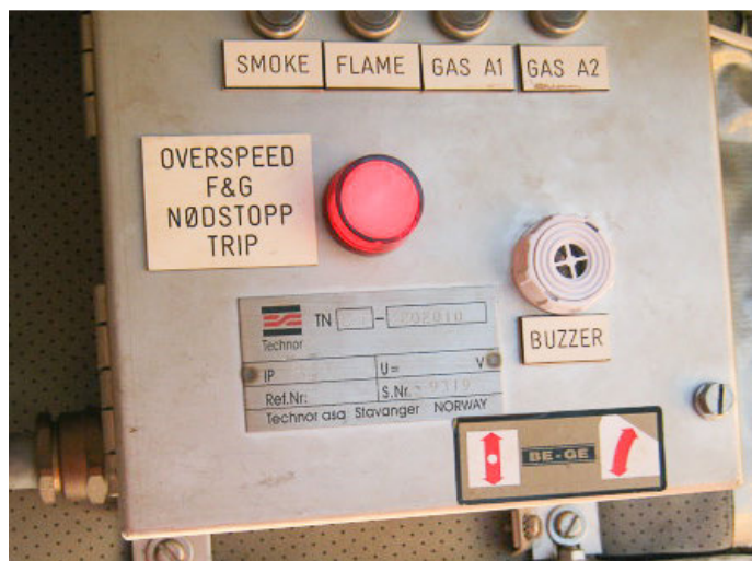
Figur 9 Kranførers brann- og gassalarmpanel i krankabin (PF-035)
