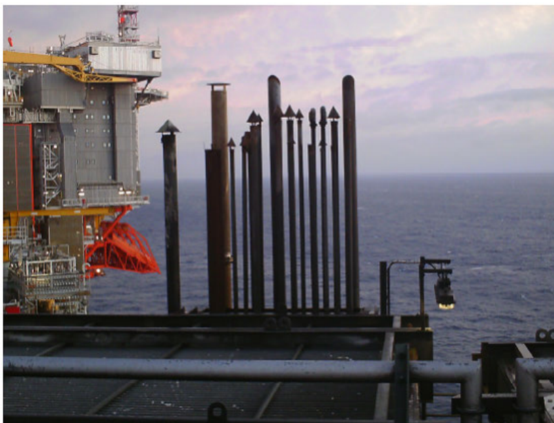
Figur 12 Lysarmatur plassert på vindsiden av avluftingsrørene.
