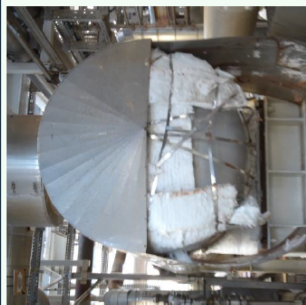
Bilde 1: Delvis avisolert gasskjøler.
