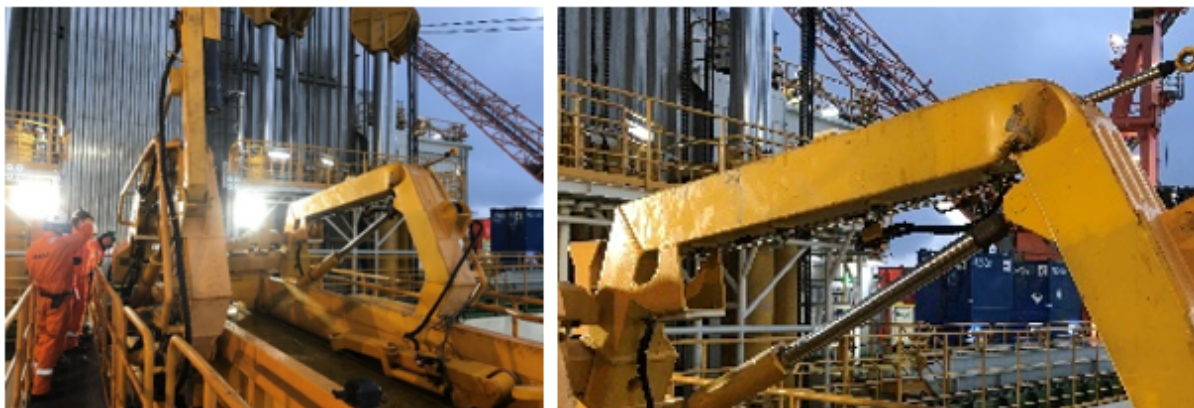
Bilde 4: Bildene viser gorillaarmene for stigerør installert på rørbroen, og hvordan disse var bøyd av vekten til stigerøret etter hendelsen. Bildene er tatt om bord av Ptil sin granskingsgruppe.
