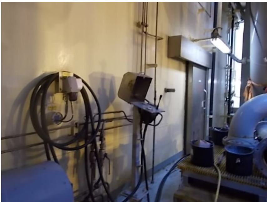
Bilde 14: Operasjonspanelet og styreventilene for å operere avlastningsopphenget for råvannspumpen
