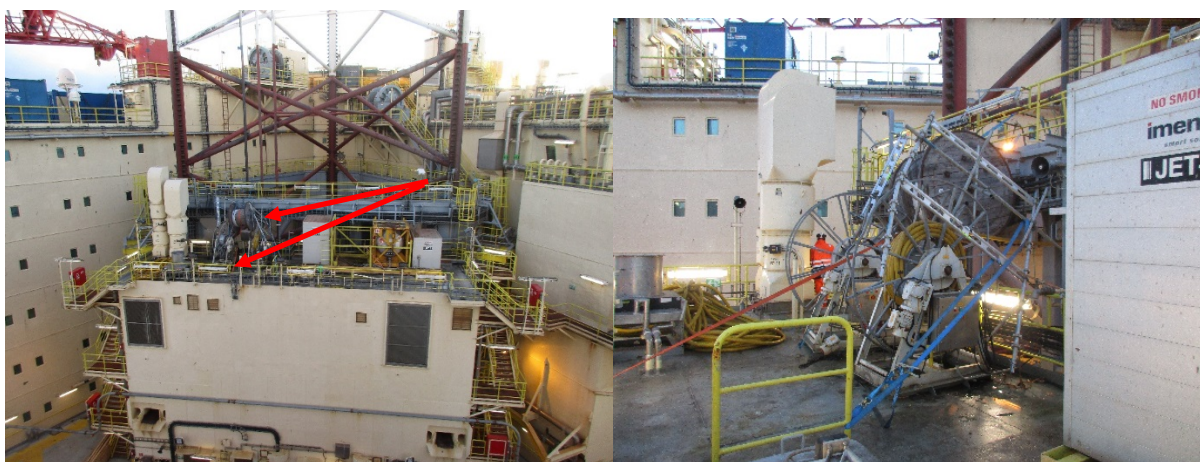
Bilde 7: Bildet til venstre viser hvor kabeltrommelen ble plassert for avspoling da råvannspumpen skulle settes på plass. Bildet til høyre viser stillaset som veltet.
