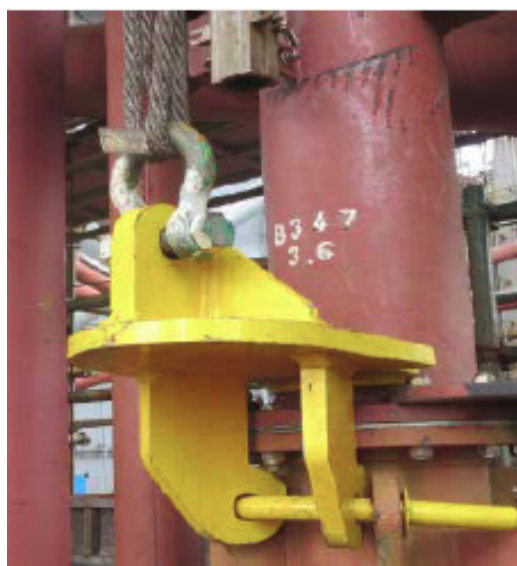
Bilde 11: Løfteåk for løfting av rørellementer til råvannspumper
