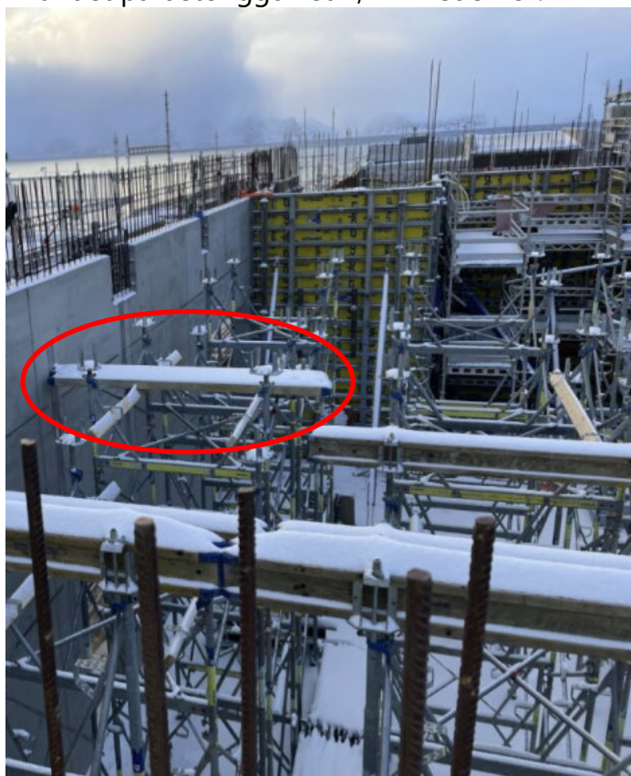
Figur 3 Bildet viser hvordan Doka bjelker var lagt ut som et underlag på stå på i mangel på Doka gulv. Markert med rød ring vises tydelig hvordan bjelkene stikker på utsiden av støtteplanken de hviler på.
