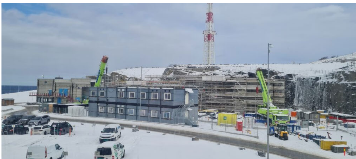
Oversiktsbilde HLNG området L202 der hendelsen inntraff (Havtil bilde)
