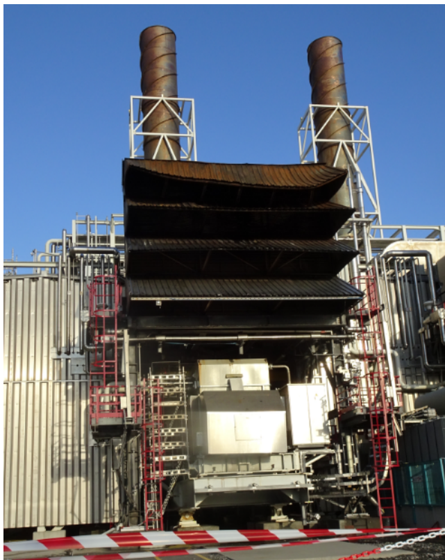
Bilde 11 GTG 4 skader på luftinntak sett utenfra (Foto: Ptil/AHS)
