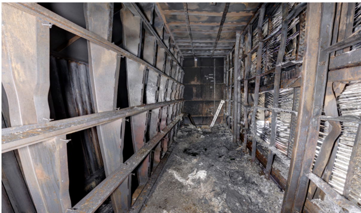
Bilde 10 GTG4 filterhus innvendig, 2. nivå etter brannen. (Foto: Kripos)
