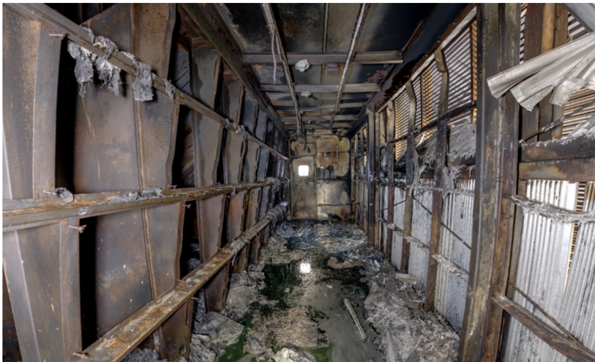
Bilde 9 GTG4 filterhus innvendig, 1. nivå etter brannen. (Foto: Kripos)
