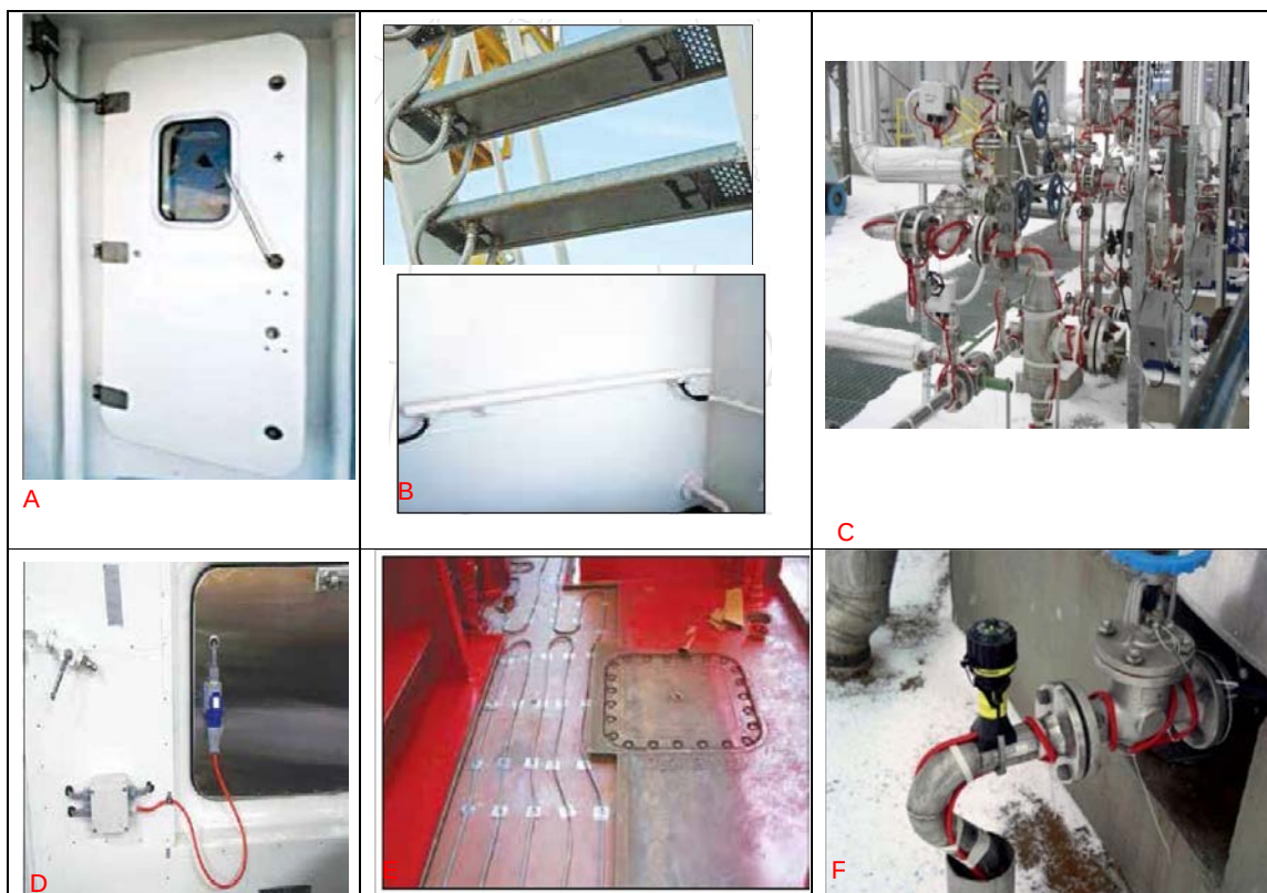
Figur 7-4 Vinterisering av noen utvalgte områder vha. varmekabler [23], A) og D) Pakninger til dører og luker - vanntette dører/luker krever tilstrekkelig varme til å forhindre ising av tetningene B) og E) trapper, rekkverk og gangveier – varmekabler for anti-ising eller avising av rekkverk og trapper for å sikre personell mot fallulykker C) og F) Væskeholdige røropplegg - antifrysing vha. varmekabel
