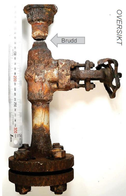
Figur 7: Konfigurasjon av grenrøret med stuss til hovedrør på toppen, pakkboksventil og blindflens. Bruddsted angitt med pil. Ventilrattet ble skadet ved fall etter hendelsen. Målestokk i mm.
