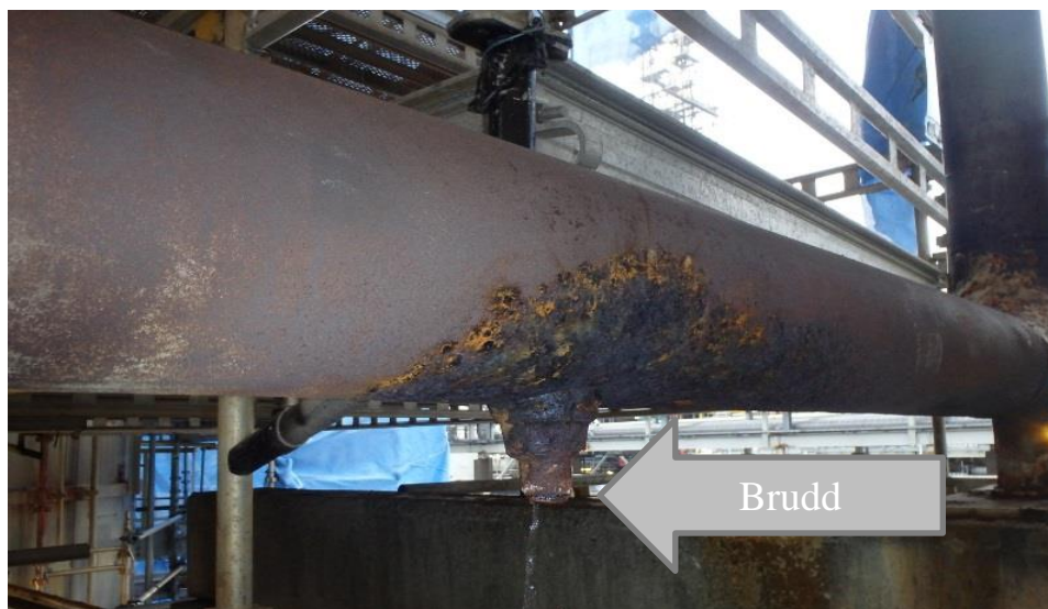
Figur 6: Hovedrør med stuss hvor bruddet skjedde. Stussen ble seinere fjernet for materialtekniske undersøkelser. Rundt stussen ser en utbredelse av utvendig korrosjon som har forgått under isolasjonen.
