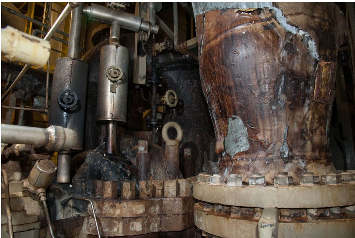
Bilde 5 - Skader etter brann ved fri-enden til lastepumpe D
