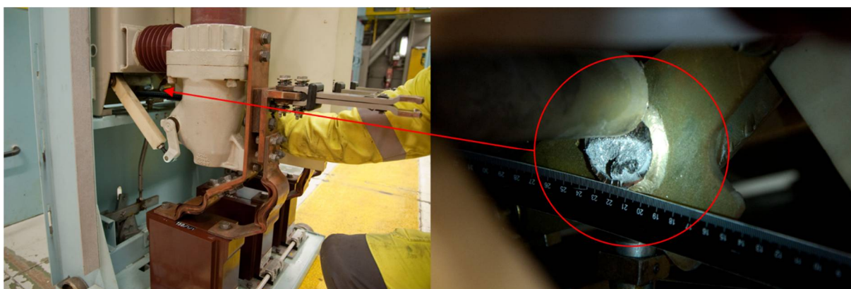
Bilde 2 - Akslingsbruddet i bryterskuff til lastepumpe D
