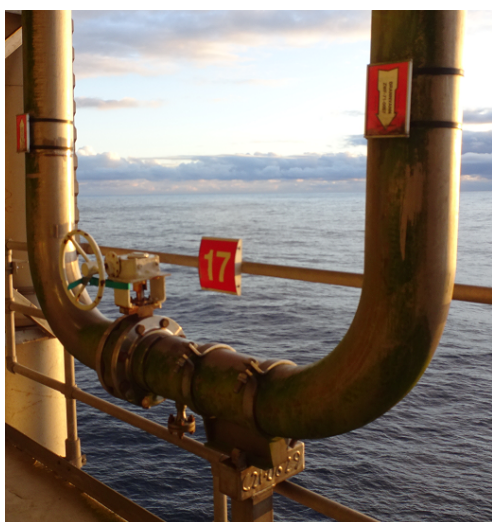
Figur 1 stengeventil på brannvannsledningen på Grane, Equinorbilde
