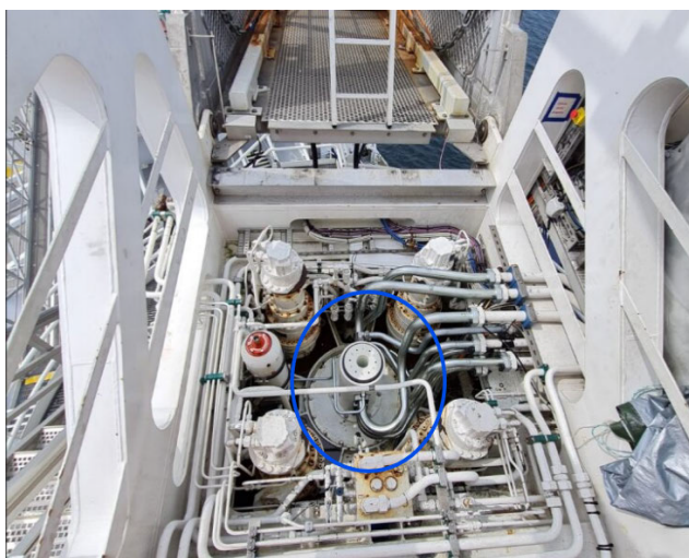
Bilde 5: Svivel og faste hydraulikk rørlinjer (Kilde: Equinor/Island Offshore)
