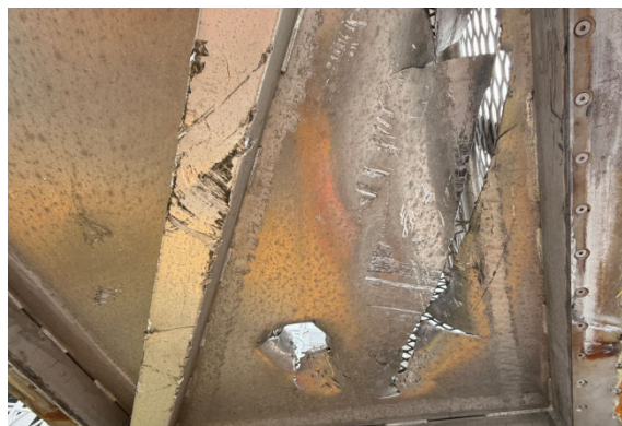
Bilde 7: Skader på gangbro (Kilde: Equinor/Island Offshore)
