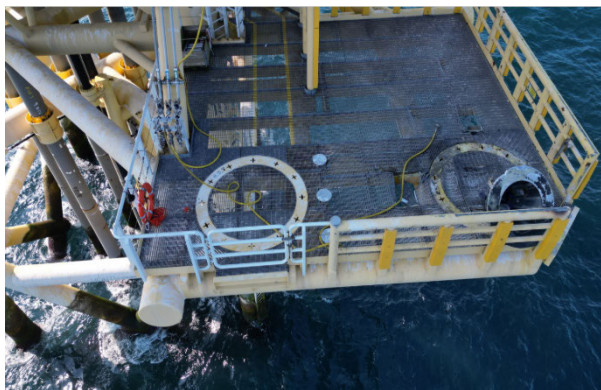
Bilde 6: Landingsplattform med skadet deksrist og løsnet kon (Kilde: Equinor/Island Offshore)
