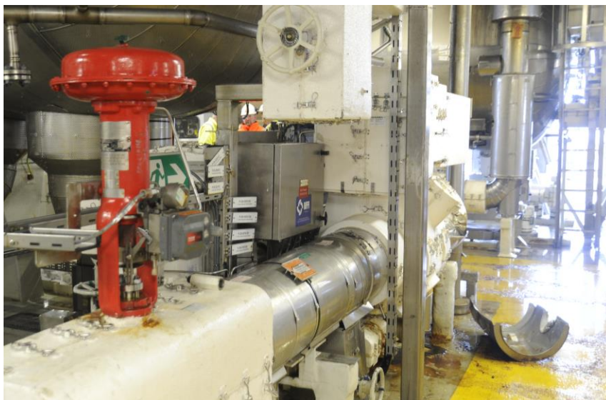
Figur 3: Reguleringsventil 20-LV0114 (rød). Dekselet nede til høyre ble bøyd opp som følge av lekkasjen og ble tatt av for å gi tilkomst for å kunne tette lekkasjen. (Foto: Politiet)
