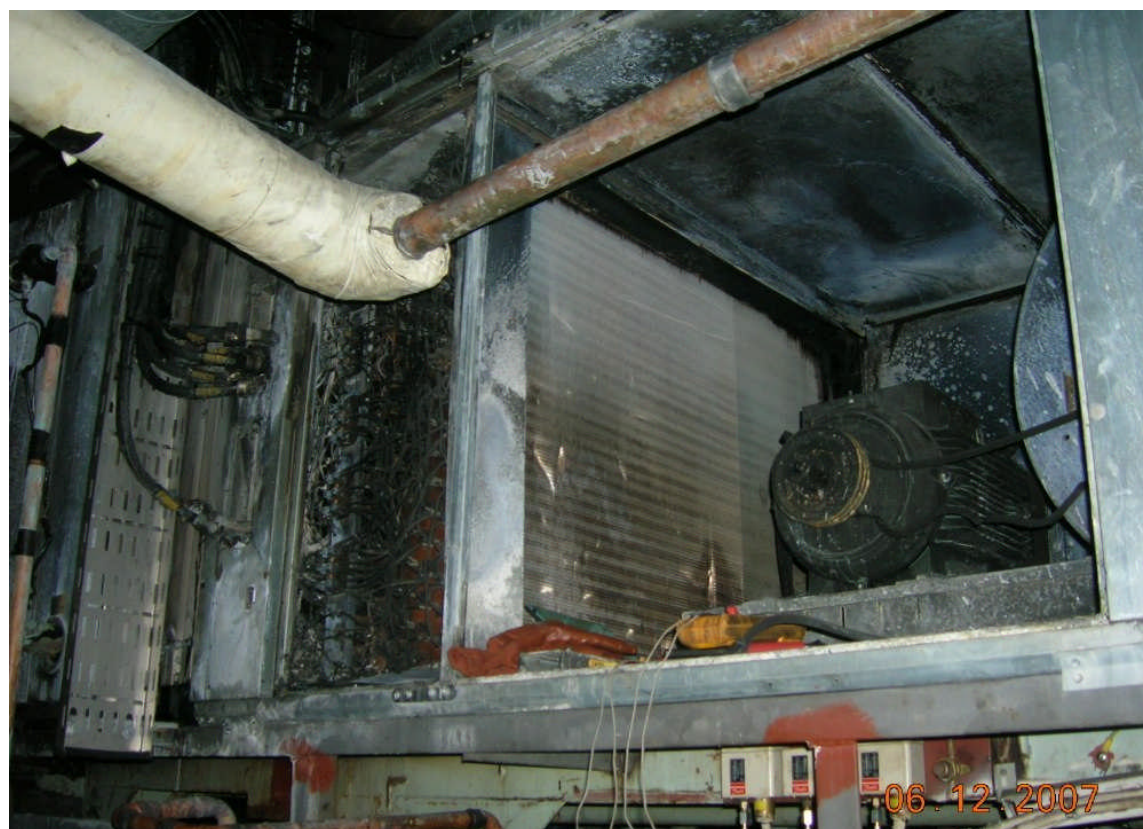
Bilde 1: HVAC-enhet 2 - varmebatteri og motor for vifte
