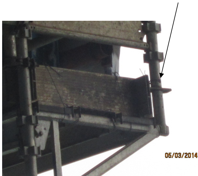
Bilde 5-Hengestillas uten sikringsbolt
