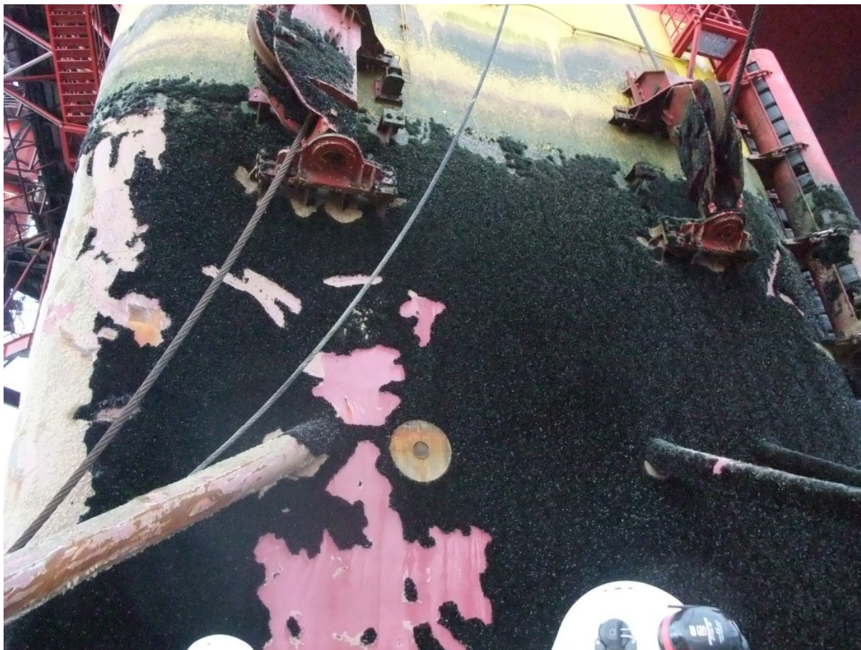
Figur 39: Bolsterskade "D", jamfør Figur 27. Det sirkulære merket midt på bildet er plassen der skråstaket er revet bort med doblingsplaten som var sveist til huden på innretningen. Merk at doblingsplaten har hatt sveis rundt både yttersiden og en indre ring (doblingsplaten har hatt smultringform). Bruddet er tydelig utviklet langs sveisene, og det er ikke merkbar buling eller plastisk deformasjon av skrogplaten, noe som tilsier at det ikke har vært et duktilt brudd. Det innvendige avstivningskrysset kan observeres, trolig på grunn av at varmen fra sveisingen ved fabrikasjon har gått gjennom platen. Sprekkveksten i doblingsplaten sine sveis mot skroget og ikke i sveisen mot skråstaket viser at doblingsplaten ikke utførte sin tiltenkte funksjon som svakt konstruksjonsledd. Blåskjellene er ikke skrapet bort rundt doblingsplaten etter den er blitt revet av, og dette tolkes som at ankeret har flyttet seg frem på bolsteret samtidig med, eller eventuelt før, ankeret flyttet lengre frem på bolsteret. Se også skrapemerker på skråstaket til venstre i bildet. Bildet er tatt i Kristiansund 12. november 2012 av Ptil.
