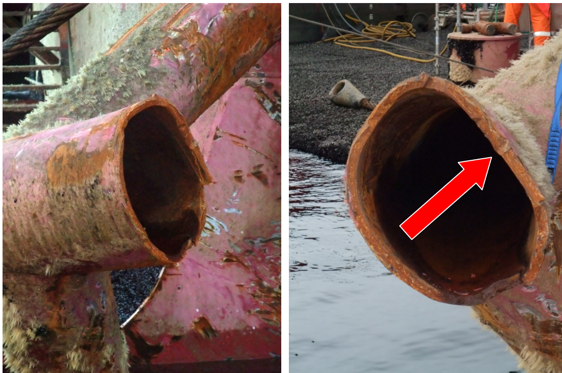
Figur 31: Bolsterets bruddflate "B", jamfør Figur 27. Bruddet har utviklet seg fra omkretsveisen ved «knekket» i bolstergeometri. Bemerk at bruddets siste fase kan ha utviklet seg ved strekkbrudd fra ankerstrekket (langs pilen) og tverrsnittet er deformert med rett form hvor etter denne delen er revet av og bolsterdelen «A-B» er falt av kort før klokken 01:40. Bildene er tatt i Kristiansund 12. november 2012 av Ptil.
