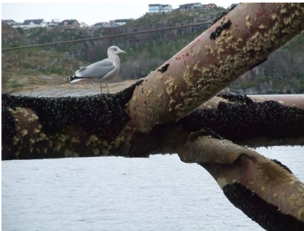
Figur 28: Bolsteret på fremre styrbord side. Anker nummer 1 har slått inn i skråstaget under bolsterelementet. Bemerk at det nederste skråstaget er helt avrevet og flyttet omtrent en diameter akter (mot høyre i bildet), og er dermed bare festet i ett punkt på siden av tank 3A-styrbord. Skadene er ikke en følge av et plutselig brudd, men har store deformasjoner etter lengre tids påvirkning. Det antas at ankerbolsteret ved anker 8 («A» jamfør Figur 27) har hatt tilsvarende skader om kvelden 6. november 2012 (alle ankrene har laget skader på bolstrene). Bildet er tatt i Kristiansund 13. november 2012 av Ptil.
