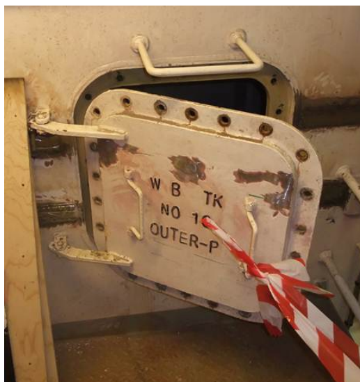
Figur 8: Mannluken fra sentralsøylen til ballasttanken "W.B. T.K. NO 10 OUTER PORT". Merker etter de midlertidig påsveiste forsterkningene fra 7.11.2012 er synlige der malingen er borte. Pakningen og boltene er tatt av. Foto tatt i Kristiansund 12. november 2012 av Ptil.
