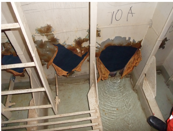
Figur 4: Tre av hullene i tank 10A sett fra innsiden. Bildet er tatt i Kristiansund, november 2012 av Petroleumstilsynet.
