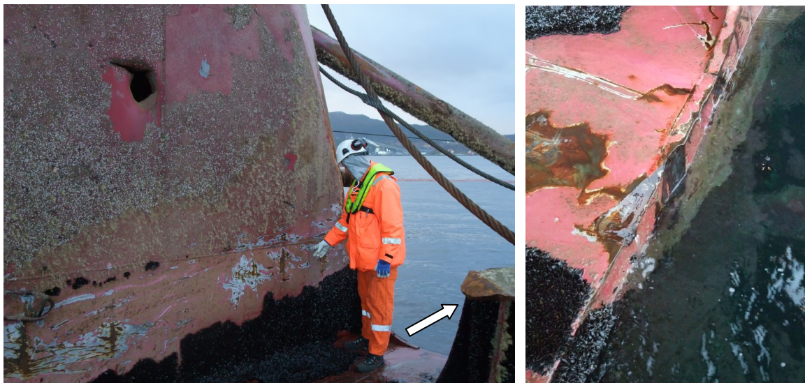
Figur 13: Hull fremst på søyle inn i tank 10. En enkelt penetrasjon før ankeret har kilt seg fast imellom skroget og bolsterdeler. Merk den bøyde platen markert med pilen, på bildet til venstre. Bildet til høyre viser omfattende slitasje på skrogplater inn mot tank nummer 2. Bildet er tatt av Petroleumstilsynet i Kristiansund 12. november 2012.
