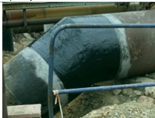
Etter utbedring - Overmalt kompositt-reparasjon
