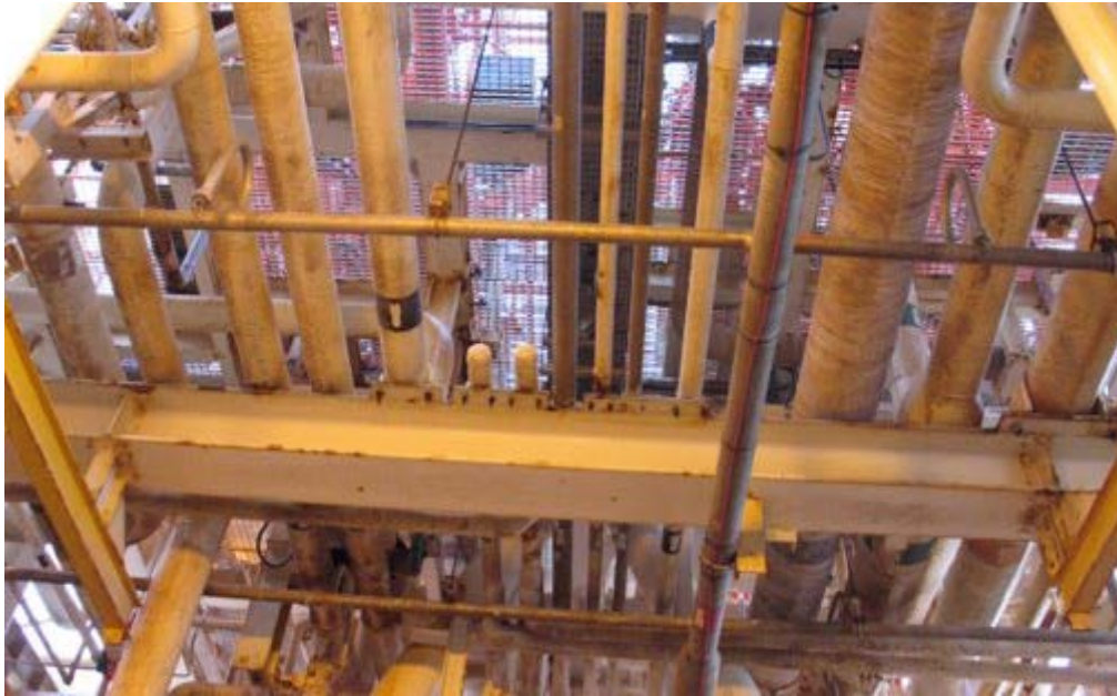
Figur 7 Eksempel på utfordringer ved reparasjon av rør – mange rør som ligger tett sammen i høyden
