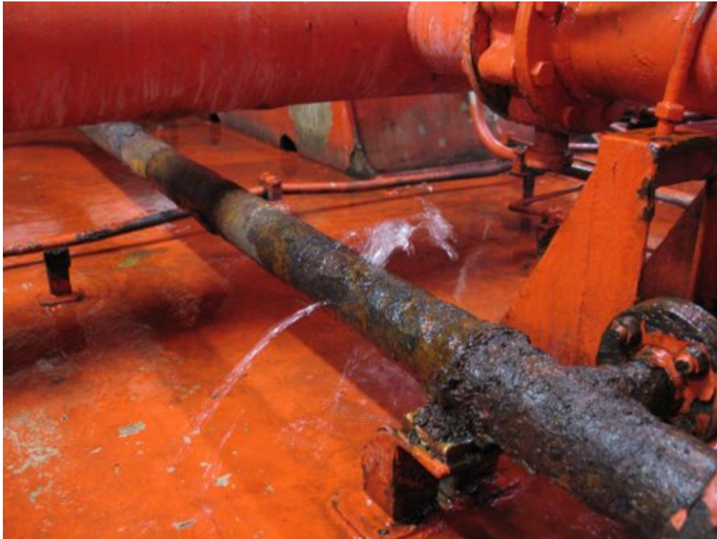
Figur 6 Lekkasje på lavtliggende vannrør
