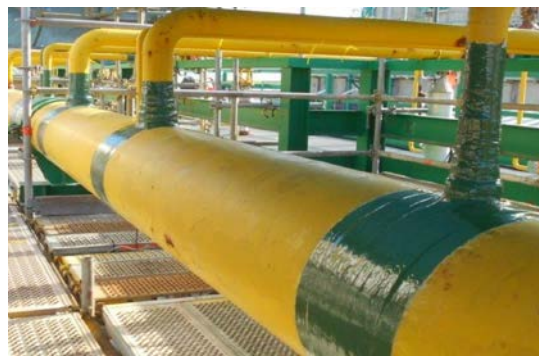
Etter utbedring - Overmalt kompositt-reparasjon
